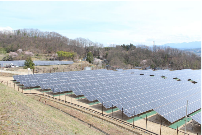
第一実業飯田太陽光発電所 (長野県飯田市)
