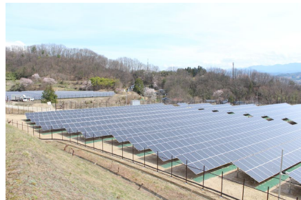
第一実業飯田太陽光発電所
