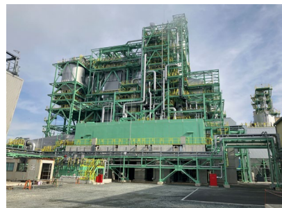
田原バイオマス発電所 (2025年4月営業開始)
