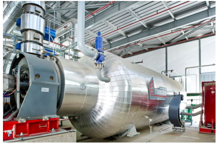
中・大型バイナリー発電システム
