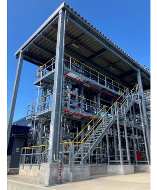
小型アンモニア製造設備
